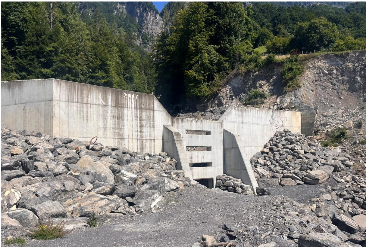
Figure A 14 Der im Jahr 2017 gebaute Geschiebesammler oberhalb von Brienz. Gut sichtbar, die Spuren der Überlastung an der Krone des Sammlers.
