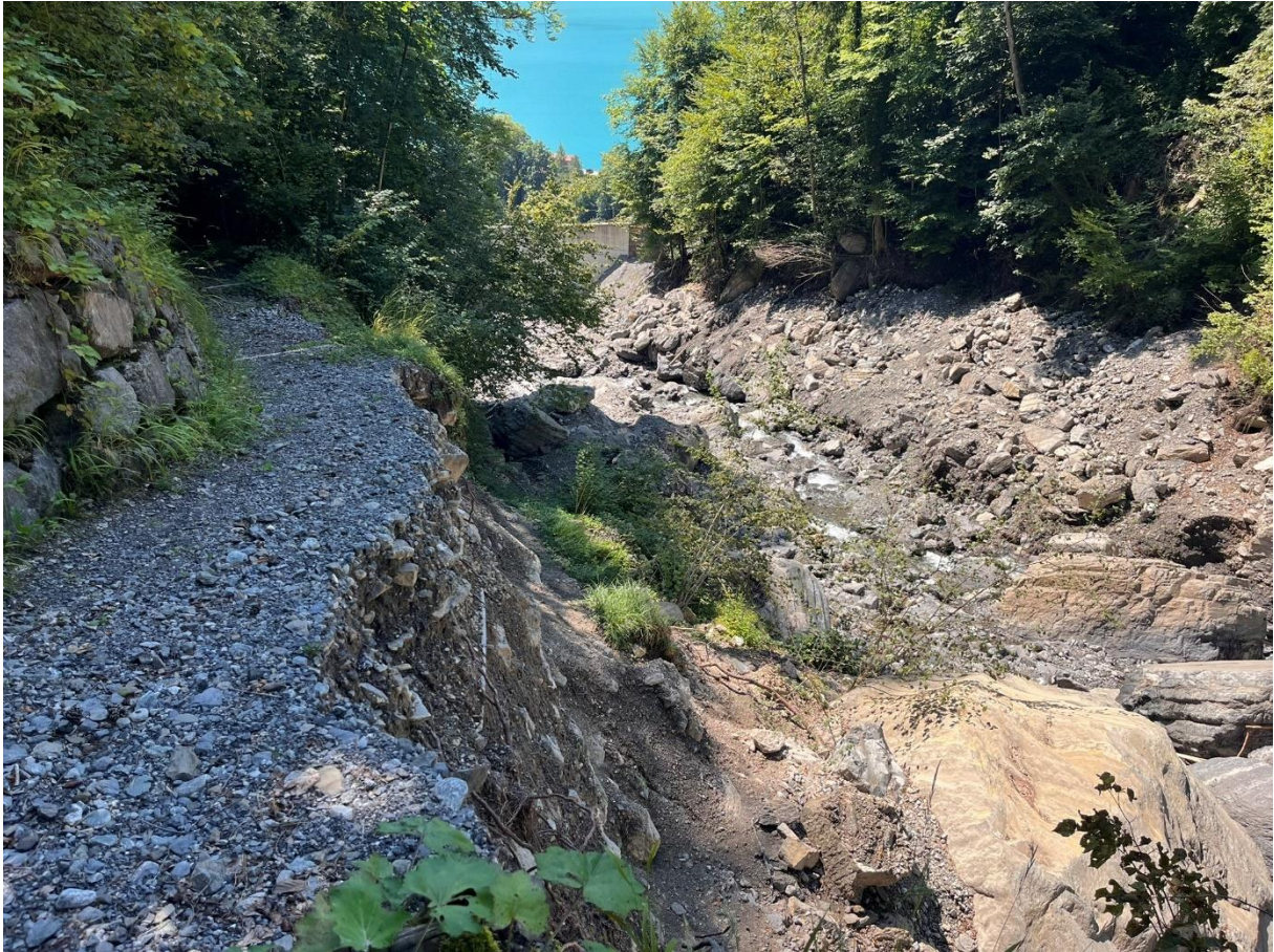
Figure A 15 Unterspülter und teilweise abgestürzter Wanderweg.
