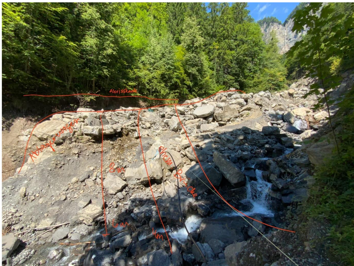
Figure A 17 Das Bachbett des Milibachs an der Stelle wo früher eine Brücke stand. Der Bach verläuft in einer bis 8m tief erodierten Rille. An beiden Ufern sind grosse Ablagerungen zu finden.
