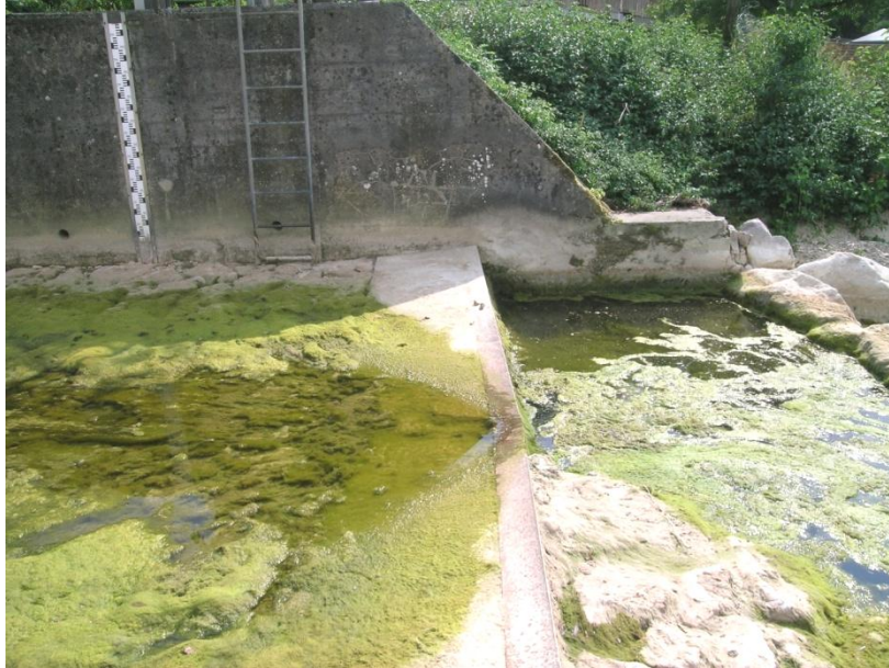
Abb. 3: Algenbewuchs an der Messschwelle der Sissle bei Eiken (EZ 331) bei Niedrigwasser im Sommer 2006.
