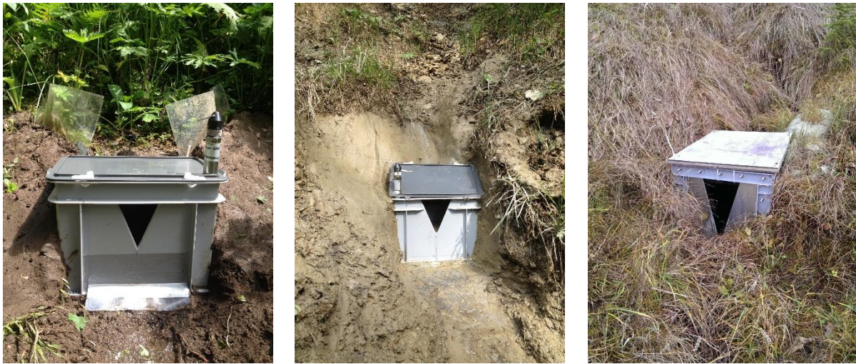
Abb. 6. Abflussmessinstallation der Makropore 81.1 (EZG 11) (l.) und der zwei Quellen 81.2 (EZG 11) (m.) und 82.1 (EZG 32) (r.) (Foto: Herrmann, Sommer/ Herbst 2013).
