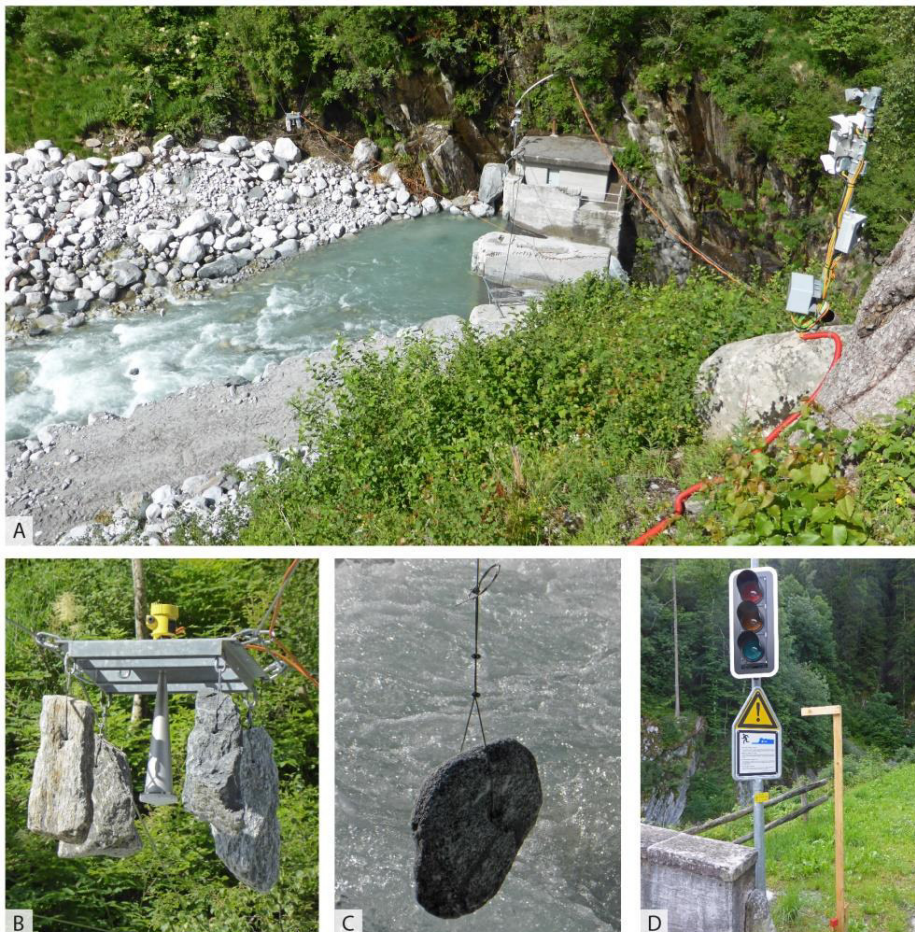
Abbildung 13: Frühwarnanlage in Prä. A: Übersicht. B: Radar-Pegelsensor. C: Reissleine. D: Automatische Ampelanlage in Bondo. Eigene Fotos Juni 2014.
